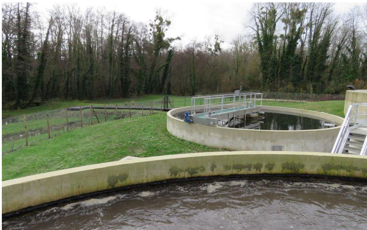
Station d'épuration du Moulin de Granville au Val-Saint-Germain
