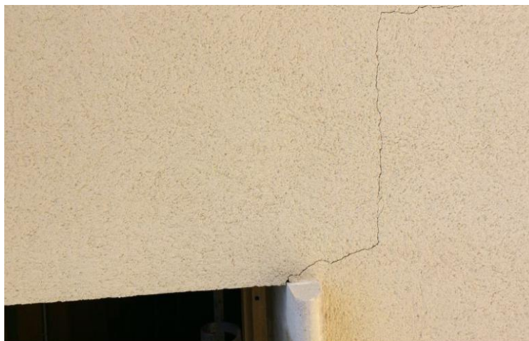
Fissuration des bâtiments liée au phénomène de retrait-gonflement des argiles à Roinville
